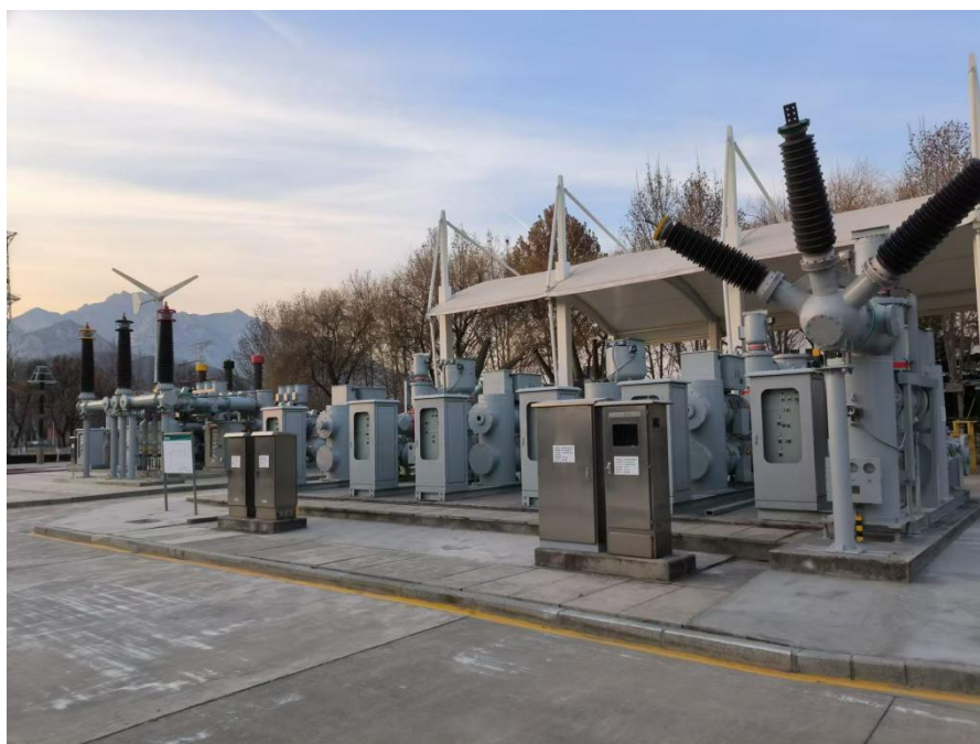
图 5-7 变电检修实训户外实训场
