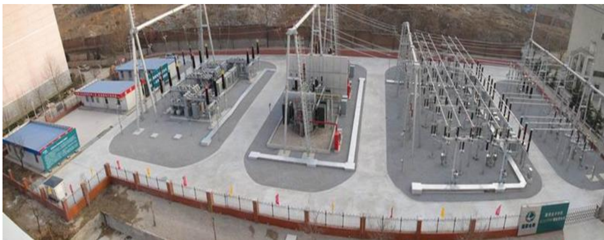
图 2- 24 实训 220kV 智能变电站鸟瞰图
