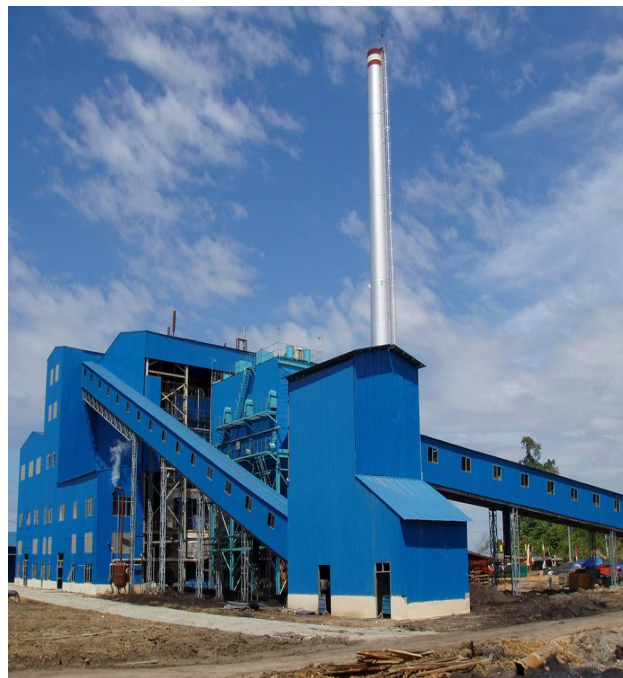
印尼IPP项目SOMA纯凝发电项目 2×130t/h CFB Boiler+2×30MW
