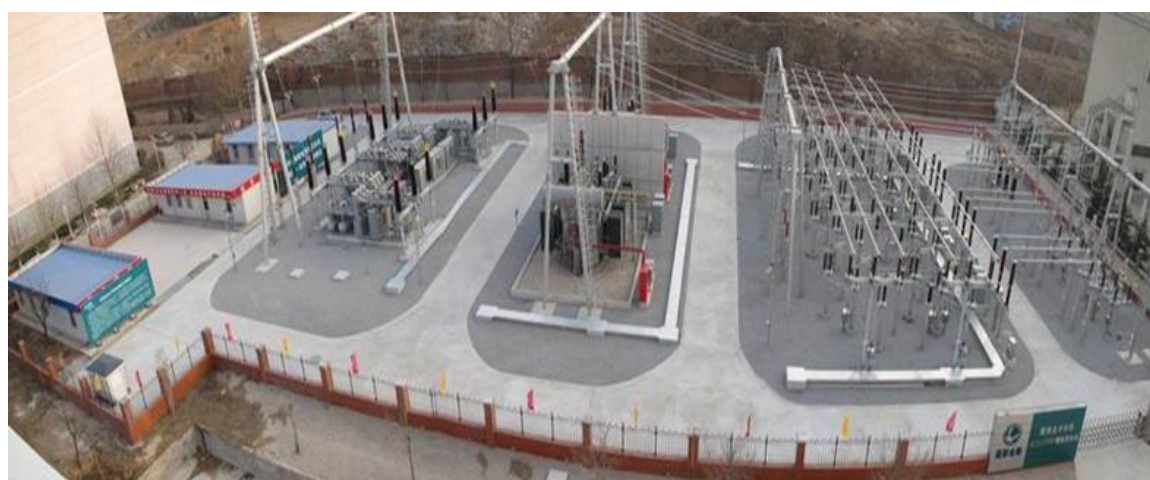
图 5-2 实训 220kV 智能变电站鸟瞰图
